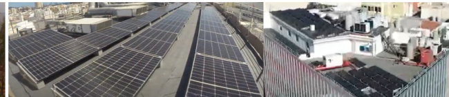
Casa Palacio + Edificio de Cristal (May 2021) 120 kW 206.944 kWh/año 121,43 tCO2eq/año
